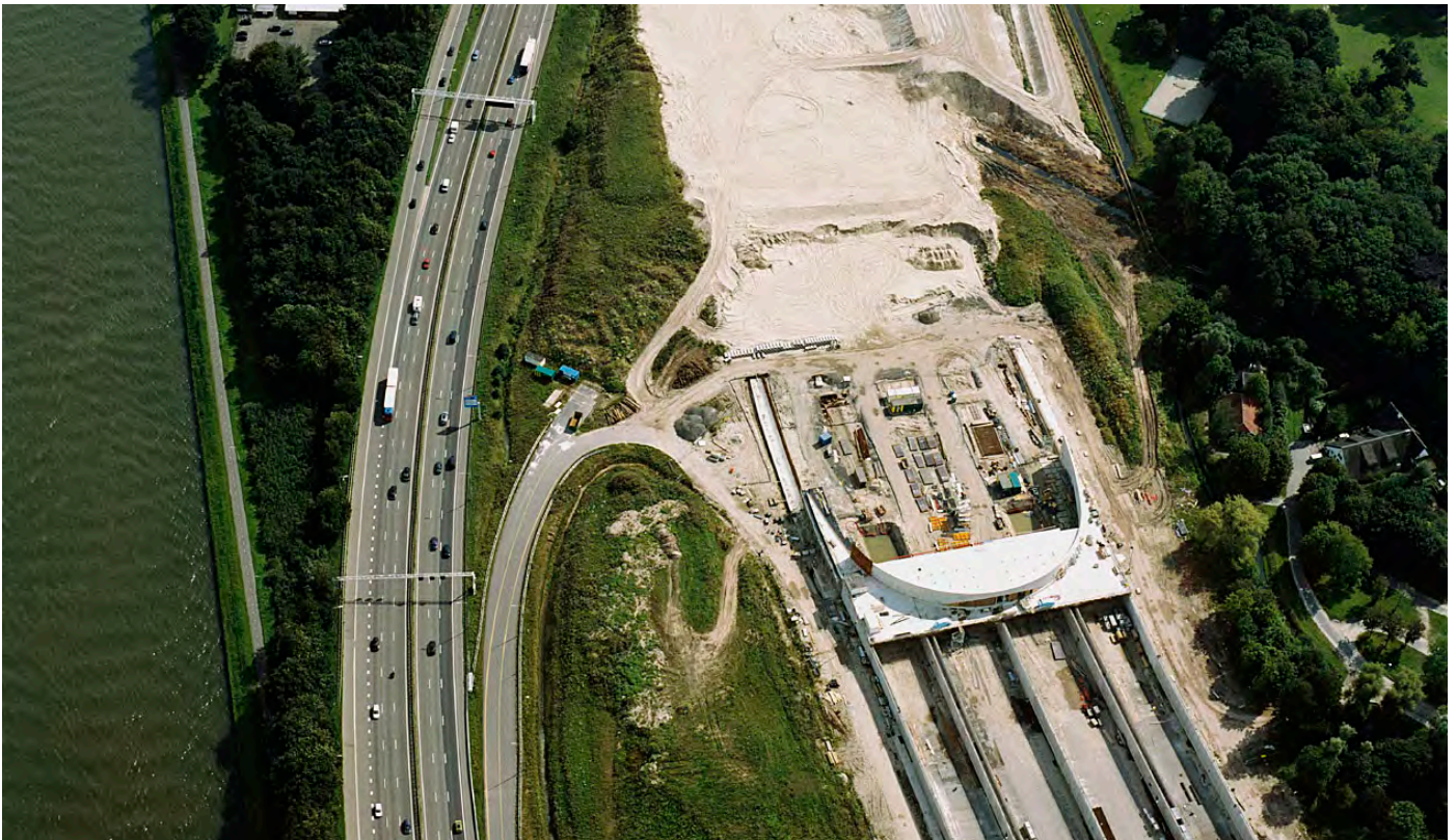
VINEX: prestatieafspraken met regio's, gefocust op infrastructuur, woningbouw en werklocaties (Aanleg Leidsche Rijntunnel, Utrecht)
