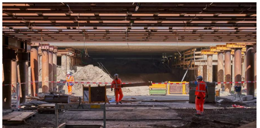
Op station Amsterdam Zuid werden grote stappen gezet in de bouw van de nieuwe Brittenpassage.
