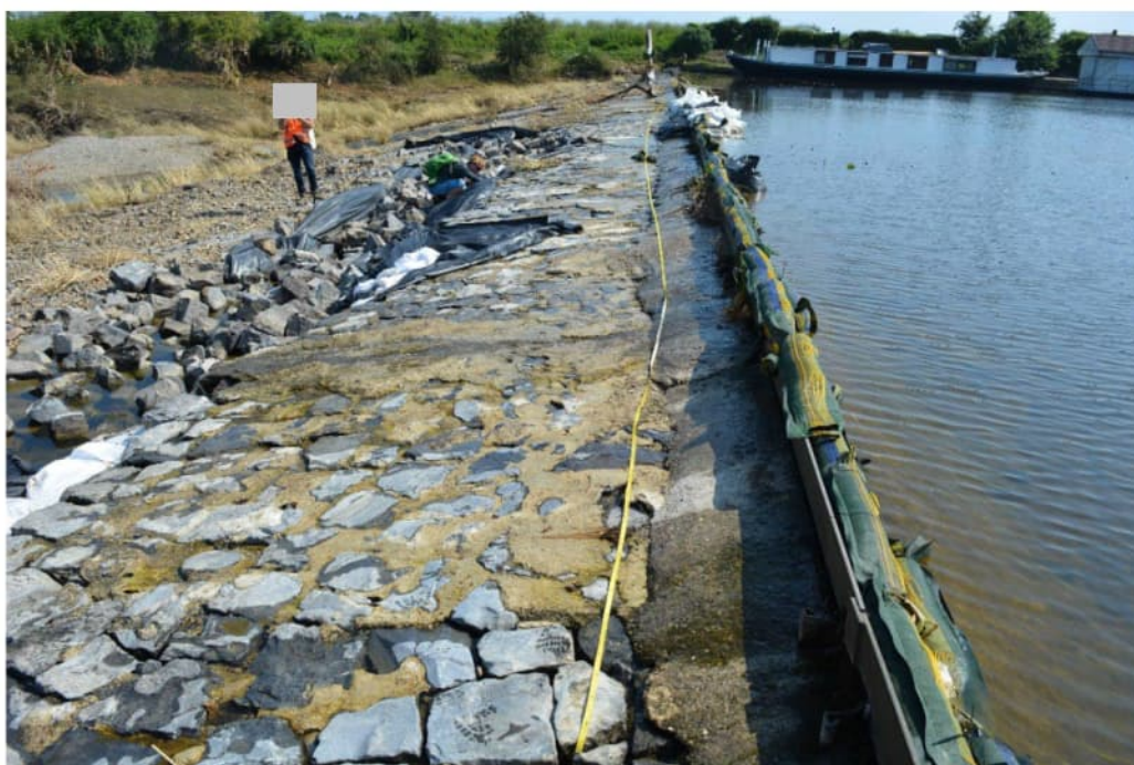
Figuur 4.6 Schade aan steenzetting en ingegoten steenzetting daarboven.
