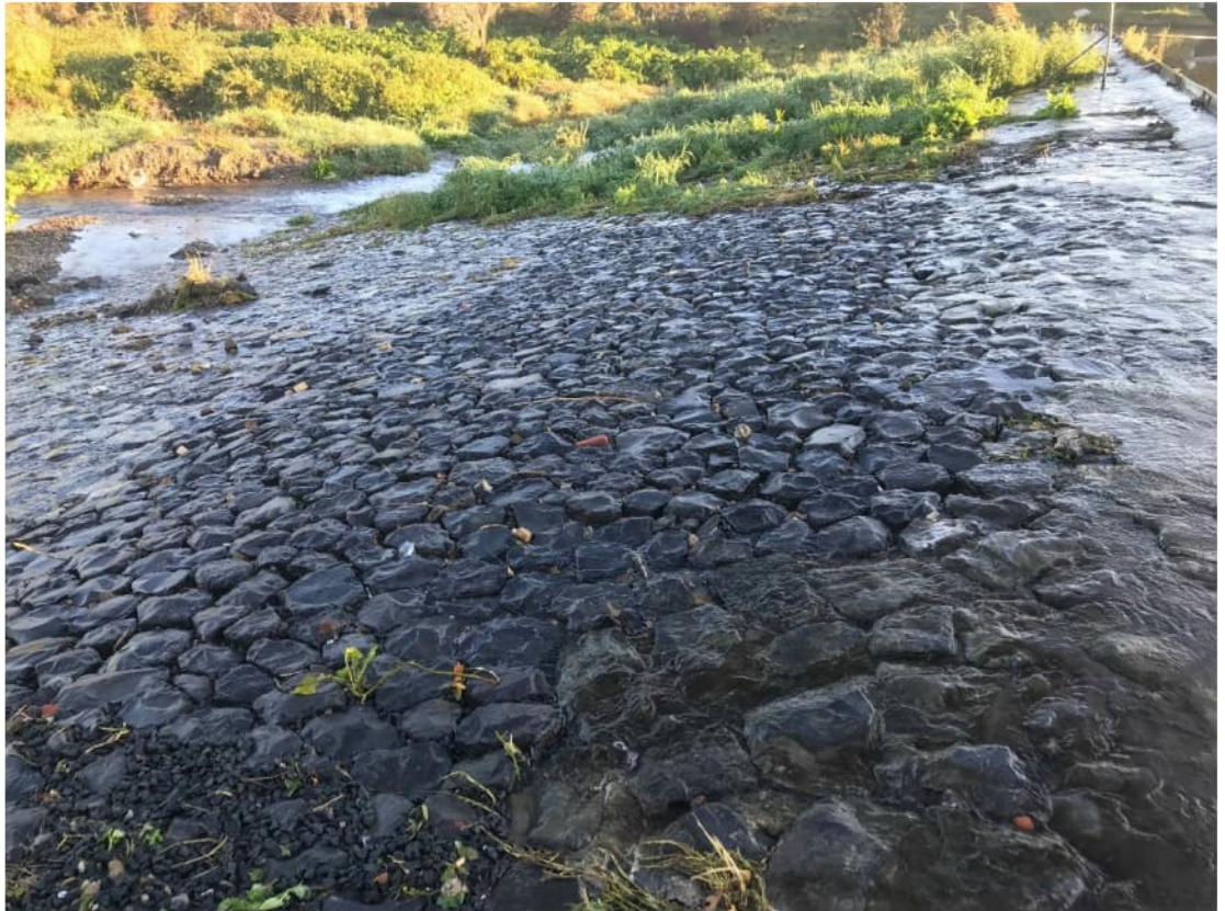
Figuur 4.9 Herstelde steenzetting, opvallend is dat ter plaatse van de herstelde steenzetting water tussen of onder de stenen doorstroomt en daarboven en daaronder over de steenbekleding.
