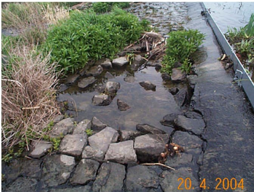
Figuur 4.15 Schade aan steenzetting in april 2004 (bron: Rijkswaterstaat-Zuid Nederland (2024a) )
