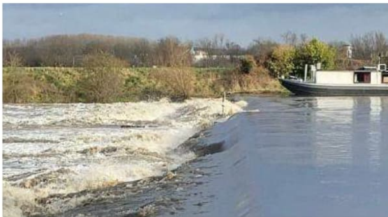
Figuur S.1: Schade aan de overlaat Bosscherveld, 4 januari 2024, Rijkswaterstaat.
