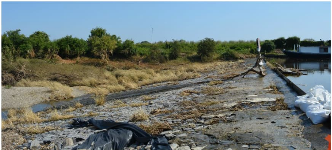
Figuur 4.3 Foto na aanleiding van de schade in juli 2021, overlaging met beton zichtbaar op kruin, mogelijk aangebracht in 2014, foto Deltares
