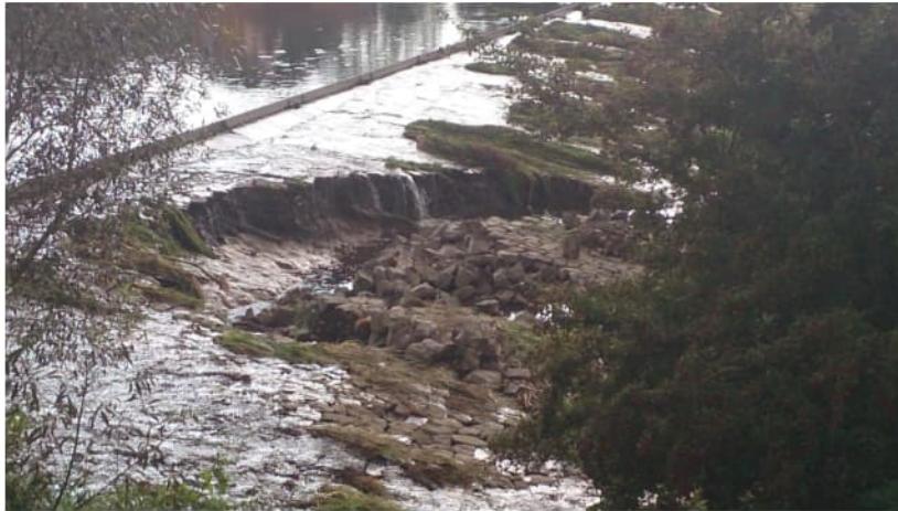
Figuur 2.9 Begroeiing rond de overlaat (vooral benedenstrooms), de foto is gemaakt in 2014 na de ontstane schade (bron: onbekend, aangeleverd door Rijkswaterstaat).
