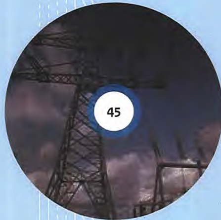
Beter Benutten Bestaande 380 kV Maasbracht-Eindhoven
