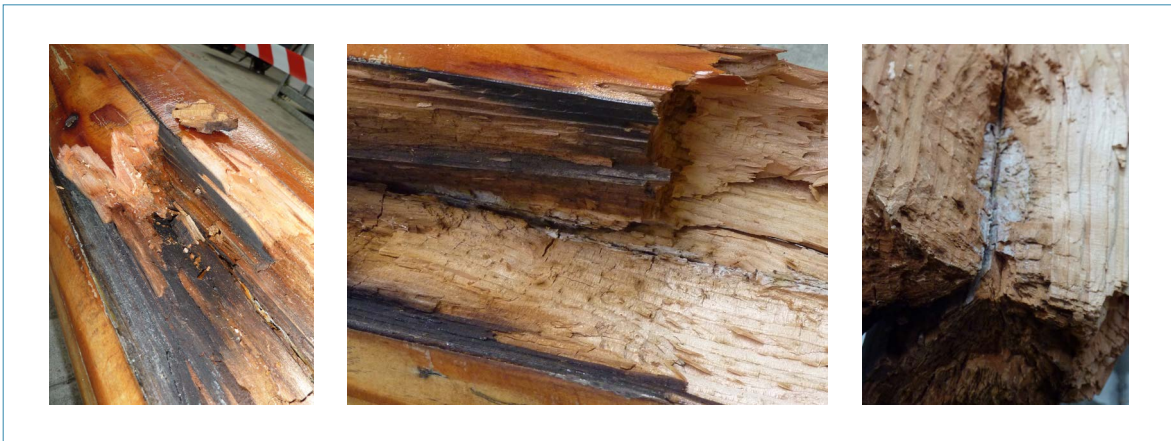
Figuur 7: Houtrot (foto's links) en schimmel (foto rechts) op de breukvlakken.
