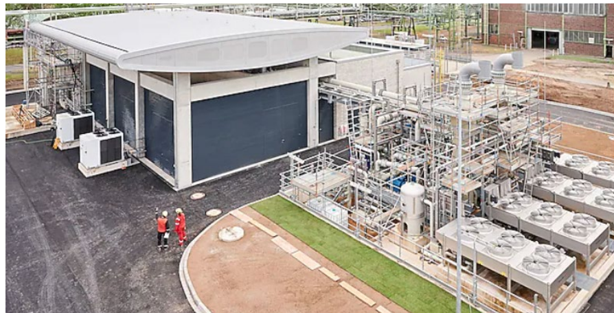
Afbeelding 3.1 Grootste Europese PEM-waterstofelektrolyser (10 MW) in het Duitse Wesseling
