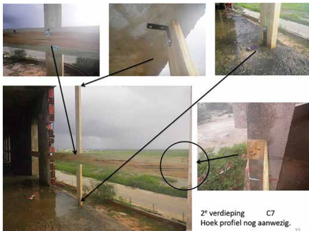
Figuur 3 Instructie voor het aanbrengen van valbescherming op de tweede verdieping van de bivaklocatie (bron: Genie, Defensie)
