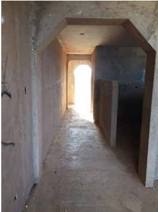
Figuur 5 Looproute van slachtoffer: rechts de gemiste trap naar beneden, midden de onbeveiligde raamopening. (bron: KMAR)
