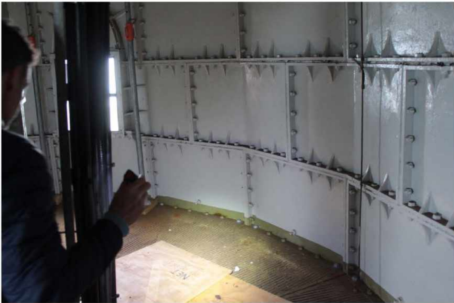
Veel gebroken bouten in buitenwand, in sommige panelen is zeker de helft gebroken.
