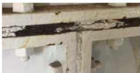
Foto 4, aantasting van ijzercementvoegen
