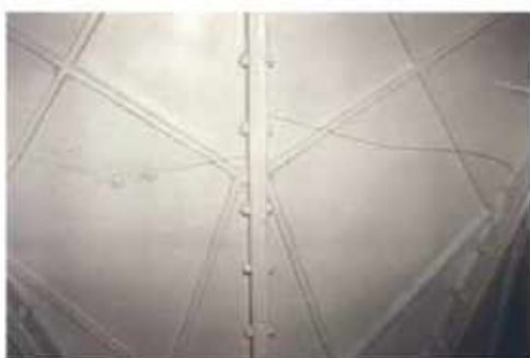
Foto 3, scheurvorming vloer (v.a. onderzijde)
