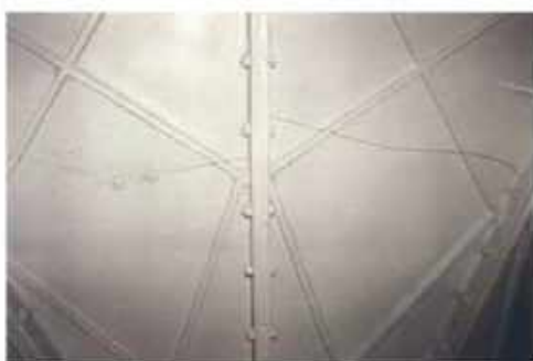
Foto 3, scheurvorming vloer (v.a. onderzijde)
