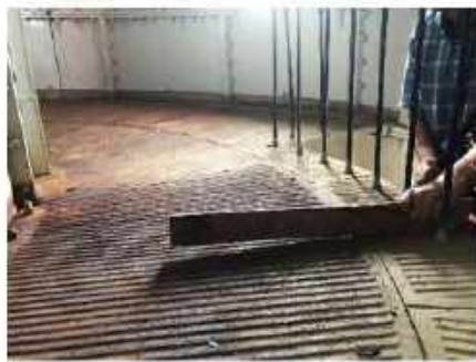
Foto 6: Zichtbaar scheve vloer
