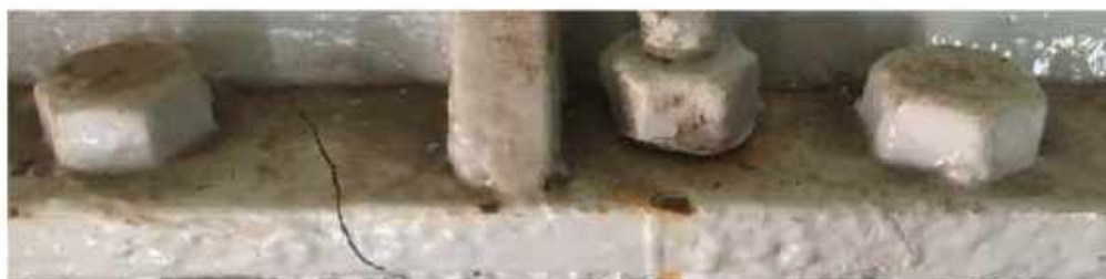
Foto 2, scheurvorming wandpaneel (binnenzijde van buitengevel)
