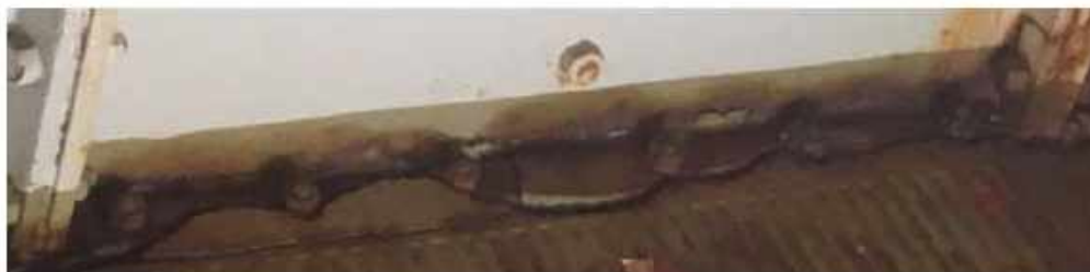
Foto 1, scheurvorming vloer nabij buitenwand
