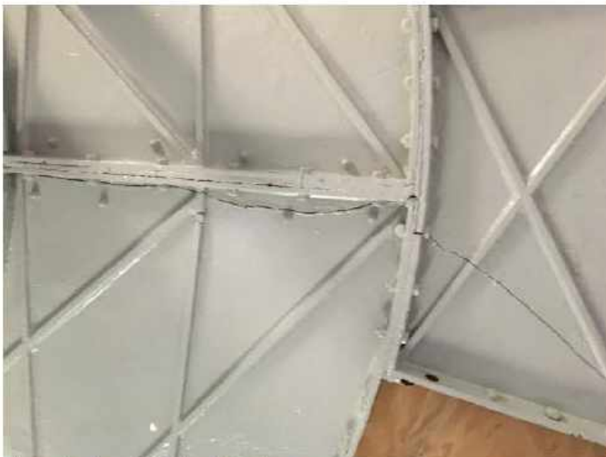
Figuur 1: scheur door vloerplaten heen
