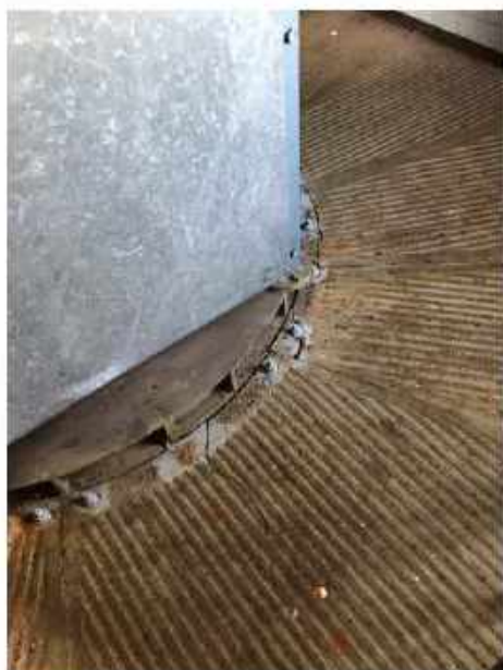
Foto 5: Vloer los van de binnenschacht
