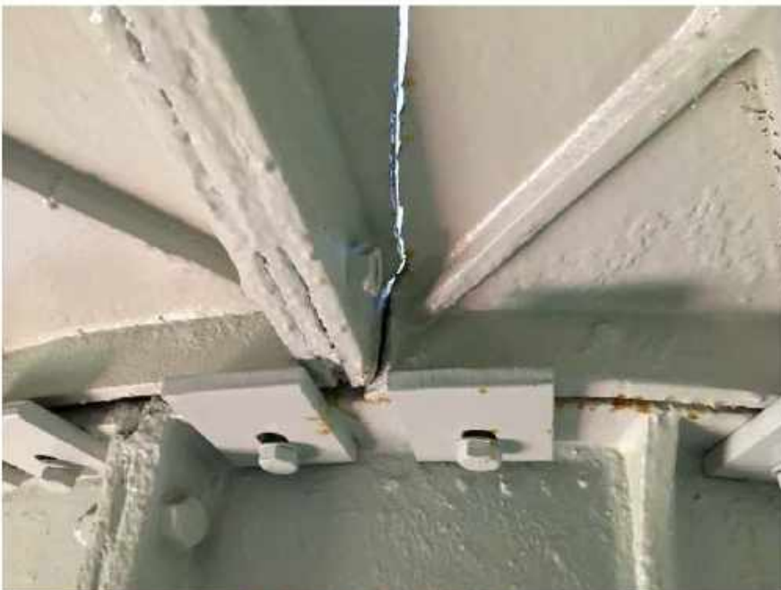
Figuur 3: scheurvorming bij "opleghandje" vloerplaat
