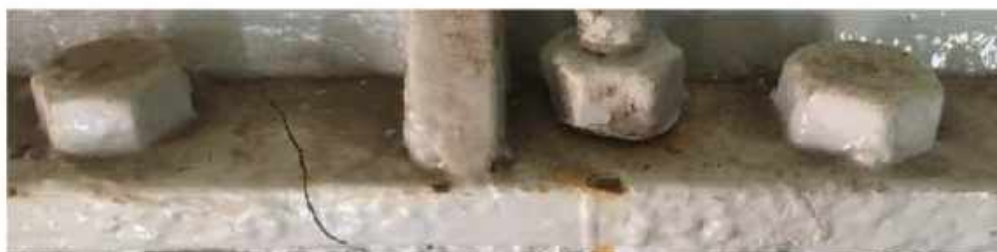
Foto 2, scheurvorming wandpaneel (binnenzijde van buitengevel)
