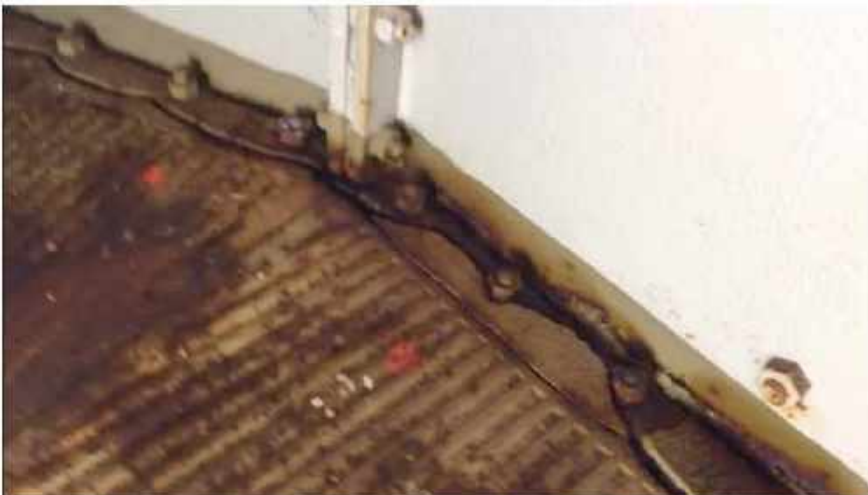
Figuur 7: scheurvorming langs vloerrand bij buitenschacht
