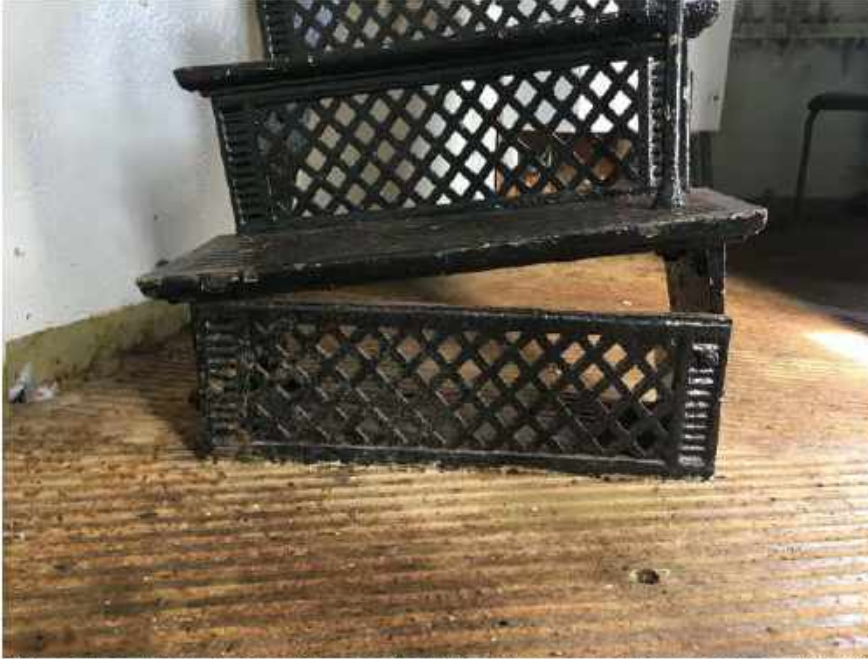
Figuur 4: onderste stootbord losgescheurd van trap, verzakking van vloer duidelijk te zien
