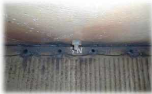
Plaat 7N, bouten verwijderd
