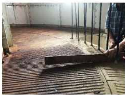
Foto 6: Zichtbaar scheve vloer
