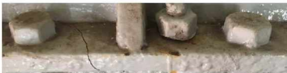
Foto 2, scheurvorming wandpaneel (binnenzijde van buitengevel)
