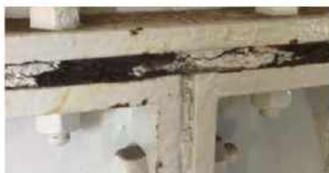
Foto 4, aantasting van ijzercementvoegen
