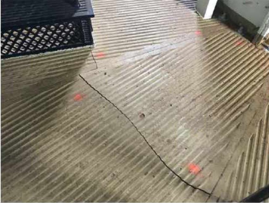
Figuur 2: scheur door vloerplaat heen
