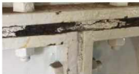
Foto 4, aantasting van ijzercementvoegen
