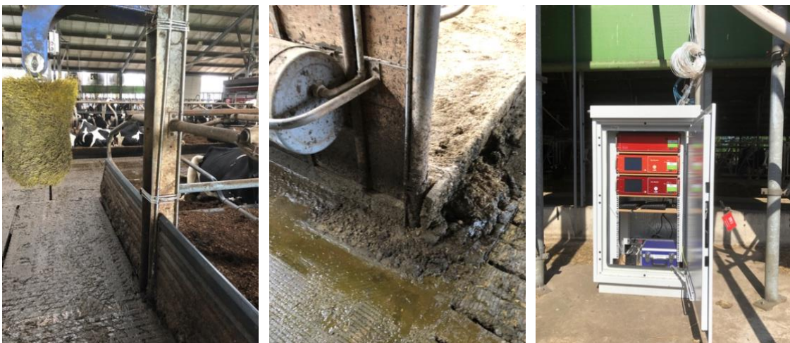
Figuur 3: De linker en de middelste foto laten zien hoe de meetleidingen onder de vloer gaan. De foto rechts is een voorbeeld van de apparatuur, die buiten in een geïsoleerde kast staat.
