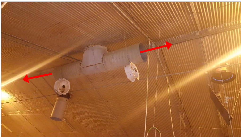
Inlaat van de voorverwarmde buitenlucht uit de warmtewisselaar naar de stal
