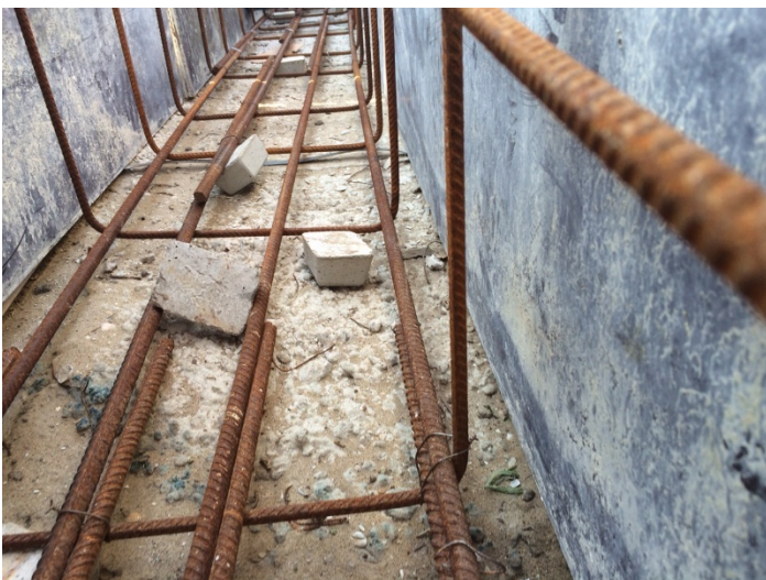
Figuur 12 Ontbrekende werkvloer (links vooraan) blok 15 (foto Toezicht Bouw Stadsdeel Oost 13-08-15)
