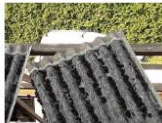
Foto: Gespijkerde golfplaat
