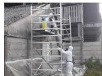
foto: Golfplaat doorsteken
