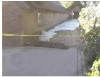
Foto: golfplaat op de grond gevallen
