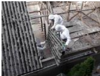
Foto: Golfplaat doorsteken
