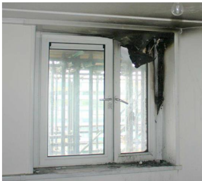
Figuur 9 Voorbeeld van een kozijn waarin de aansluiting van de ramen op de kolommen is bezweken en het glas nog intact is
