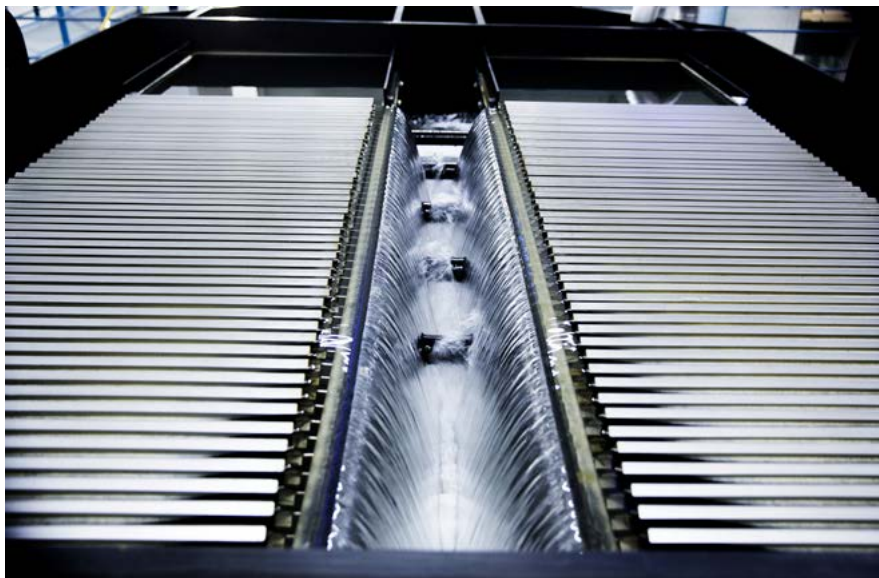
Nieuwe waterzuiveringsinstallatie van PWN in Andijk
