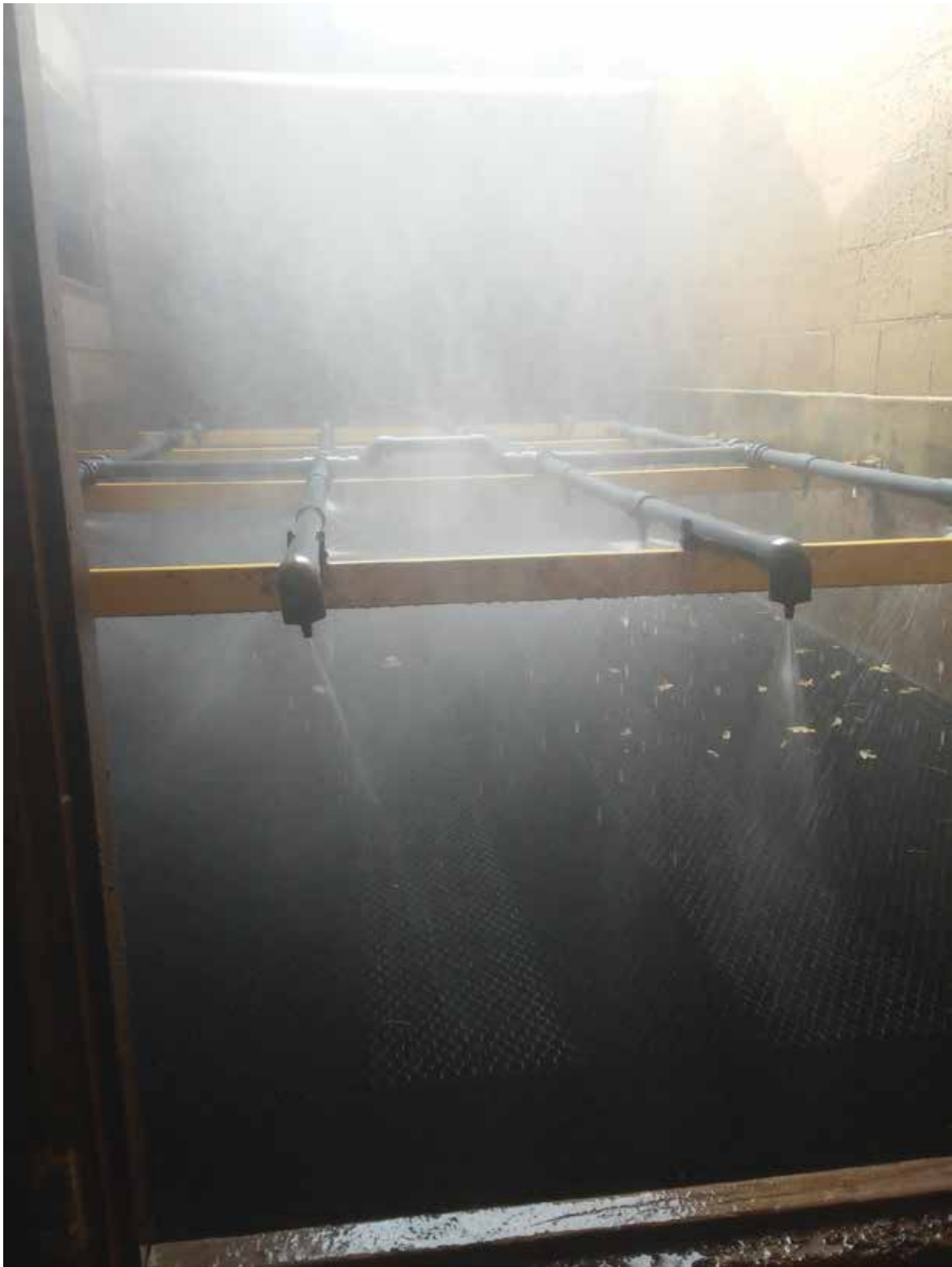
Figuur 8 Bladeren zichtbaar op het waspakket; de voorgeschreven druppelvanger is niet aanwezig.
