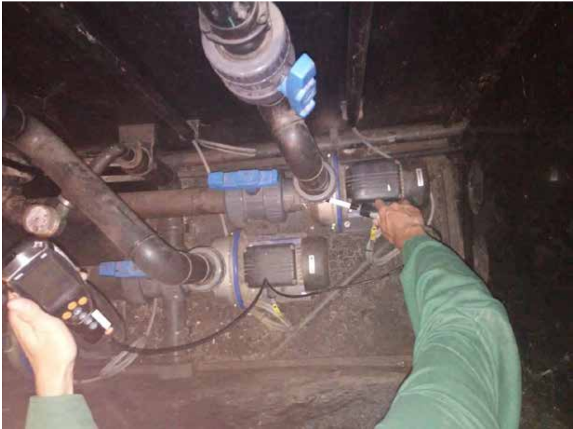
Figuur 1 Temperatuurmeting bij de pomp waarmee het waswater wordt gerecirculeerd.
