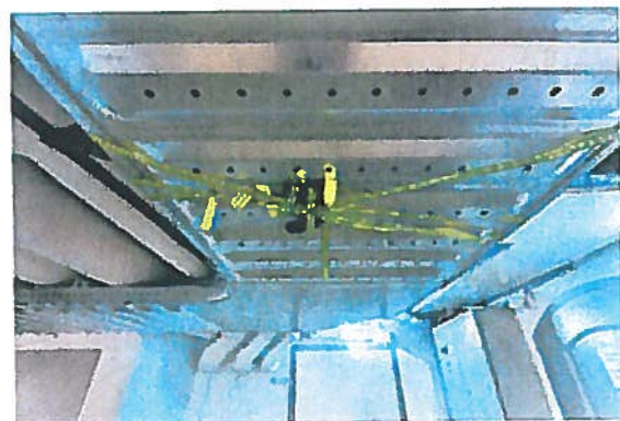
noodmaatregelen overvolle kabelgoten Eerste Kamer
