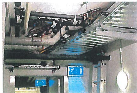
overvolle kabelgoten in combinatie met wirwar van (water) leidingen en bekabeling, BH7 Tweede Kamer
