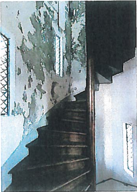
achterstalling onderhoud Mauritstoren Eerste Kamer
