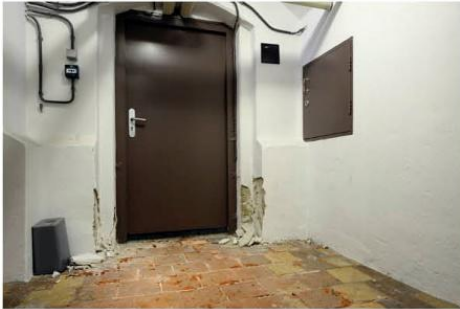
Gebreken veroorzaakt door vocht in kelder
