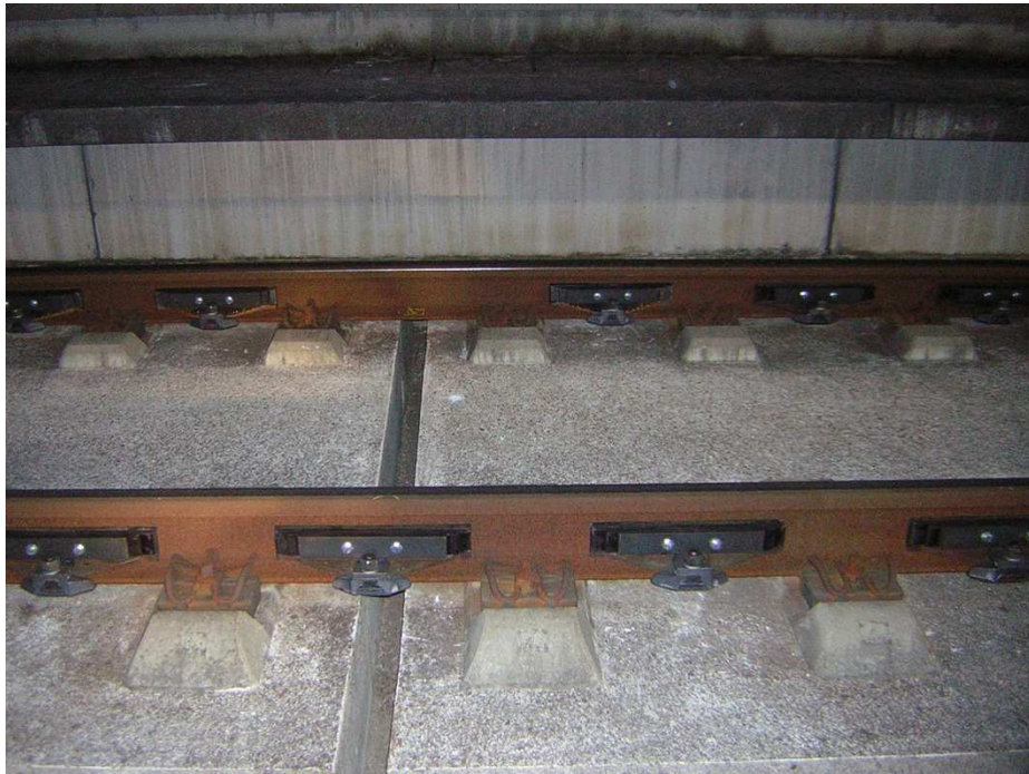
Figuur 7 Raildempers op het westspoor bij doorsnede D2. Deze zijn over een strekkende lengte van 100 m aangebracht.
