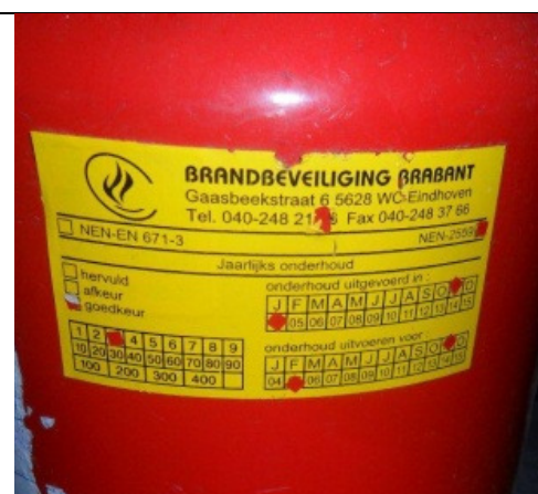
Brandblusser niet goed onderhouden, keuring verlopen
