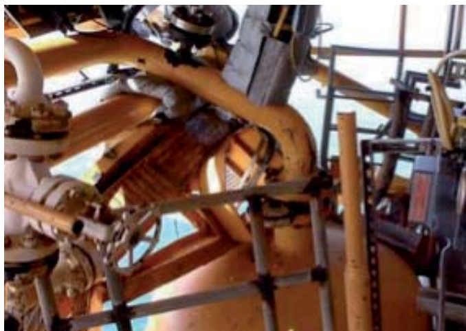
Schade aan mijnbouwinstallatie na aanvaring met DSV, eind 2011
