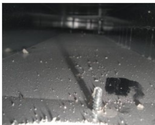
Figuur 14: Voorbeeld van een toevoerkanaal waarin bouwstof (vermoedelijk spuitpleister) is aangetroffen.
