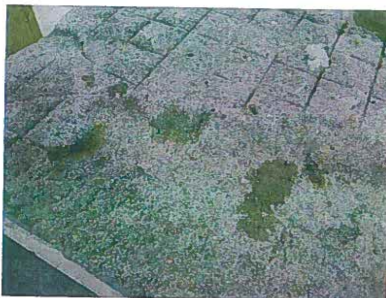
Foto 2 Vochtige plekken in de zand-cementvloer.
