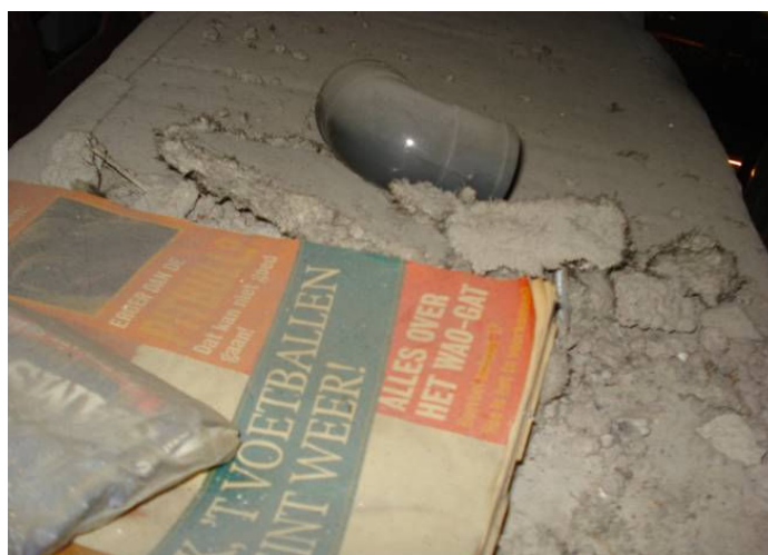
Figuur 5-2: Spuitasbest, met veelal amfibool (amosiet of crocidoliet) asbestvezels die gemakkelijk los komen van de matrix, in 2009 aangetroffen in een gebouw dat rond 1994 is gesaneerd (foto ter beschikking gesteld door BME Asbestconsult B.V.).
