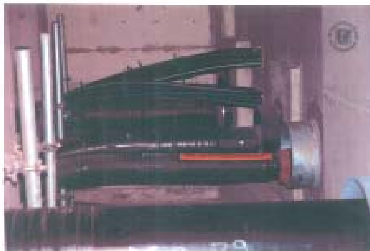
Foto 5-7 Doorvoering in het eindgebouw Zuid (binnenzijde) van de leidingen voor achtereenvolgens kerosine, ethyleenoxide (met rode band) en waterstof, onmiddellijk na het incident (ref. 1.r)
