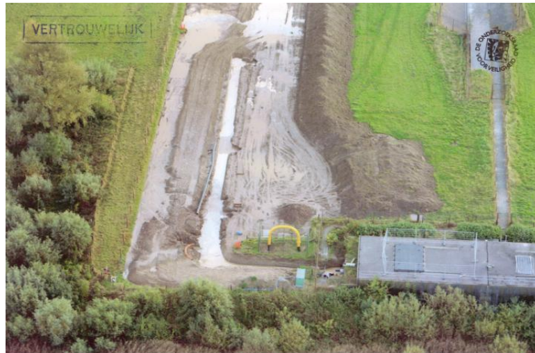
Foto 5-4 Rijsporen bovenop liggende leidingen, veroorzaakt door een "zware" graafmachine (ref. 1-r)
