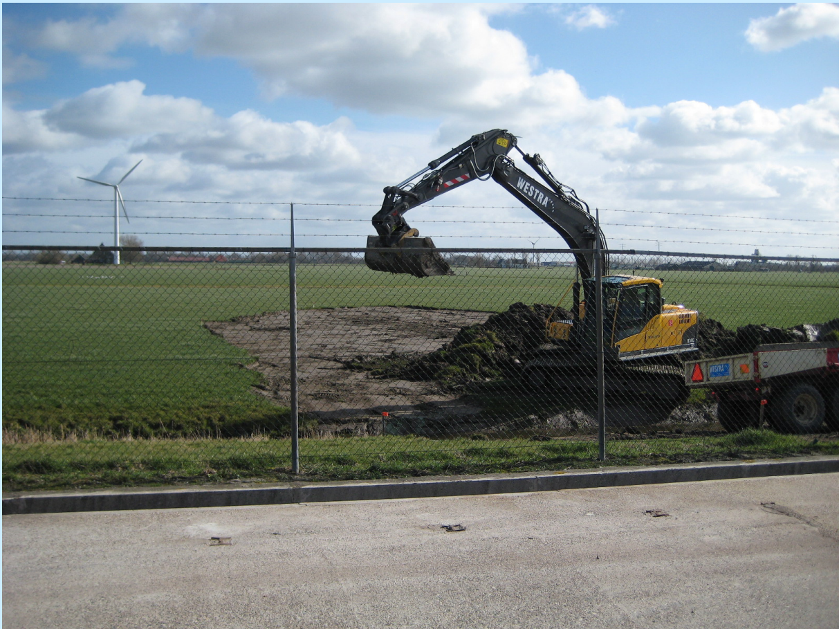
De sanering van het door base oil vervuilde weiland, gaande direct achter het hekwerk van het mijnbouwwerk (Foto SodM).
