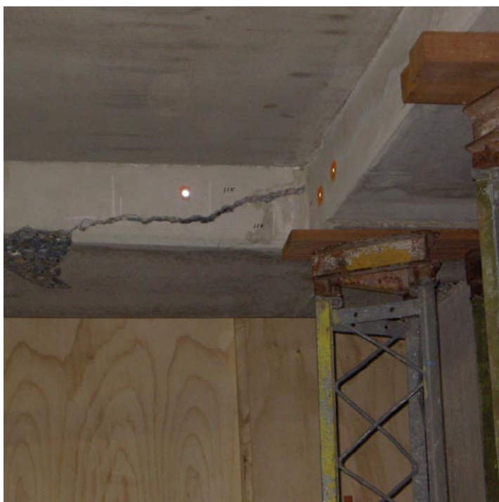
Gescheurde nok in parkeergarage Bos en Lommer
