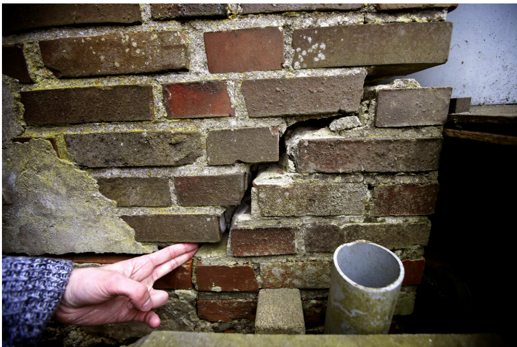
Een scheur in de muur van een woning in het Groningse Leermens. (ANP / Catrinus van der Veen)
